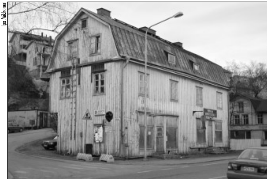
Kierrätyskeskuksen talon kehikko uhkaa vajota, mutta tämä on estettävissä.
