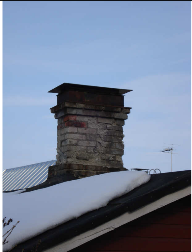
Ajan patinoima savupiippu. Savupiipun ulkoasua ei kuitenkaan ole tarve suojella, sillä parinkymmenen vuoden kuluttua ovat naapuritalojenkin savupiiput samassa kunnossa (kuva 28.b)
