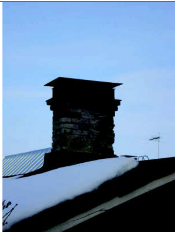
Ajan patinoima savupiippu. Savupiipun ulkoasua ei kuitenkaan ole tarve suojella, sillä parinkymmenen vuoden kuluttua ovat naapuritalojenkin savupiiput samassa kunnossa (kuva 28.b)
